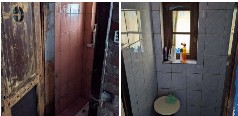
Spoločné toalety na medzizipochodiach v bytovom dome s mestskými nájomnými bytmi 3. a 4. kategórie v segregovanej lokalite v Žiline Fotografia: Amnesty International, 22.2.2024
